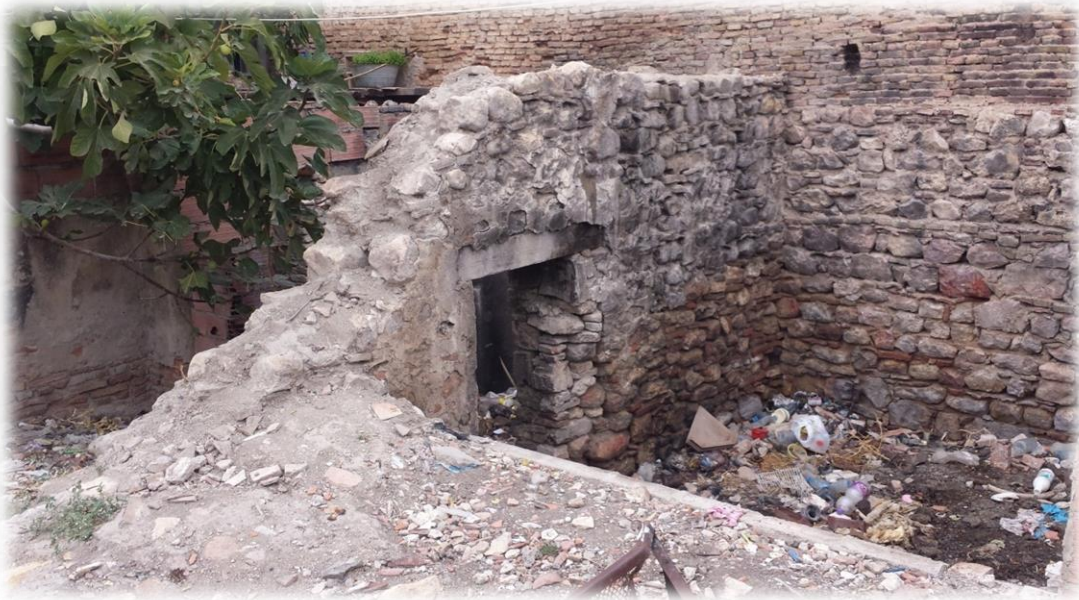
صورة (155):بقايا انهيار المباني
