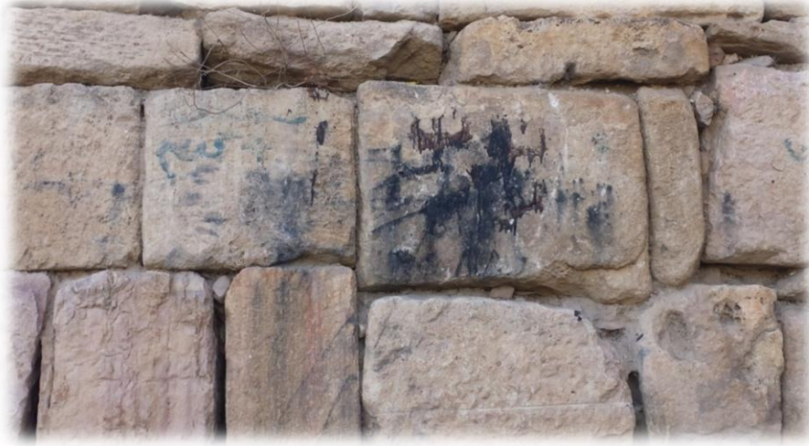
صورة (174): ضعف مواد البناء
