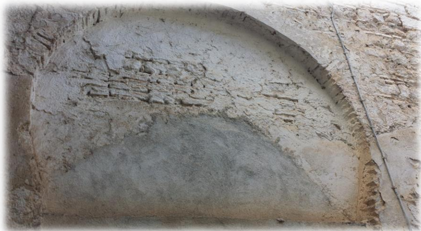
صورة (168) أخطاء الترميم الاستعماري
